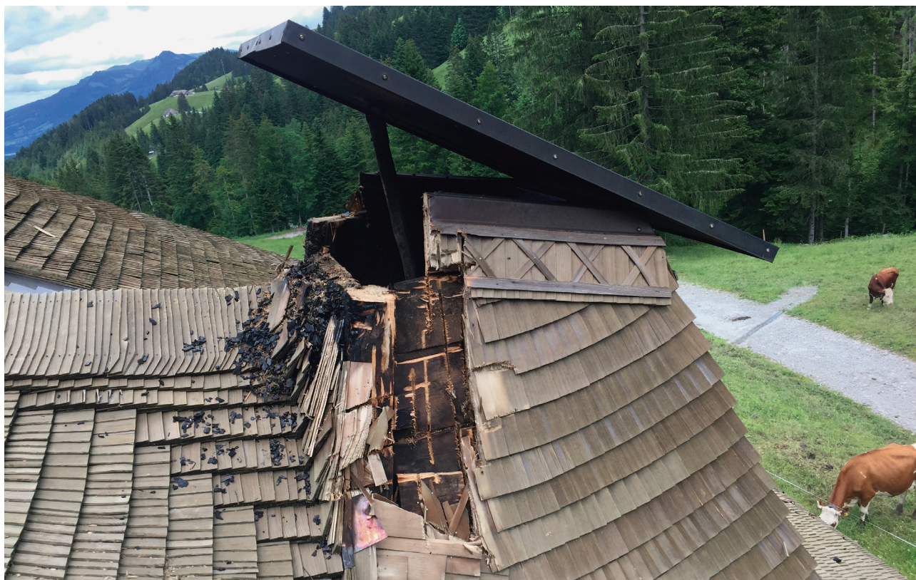
Schadensbild : Brandausbruch am Kaminausgang im Bereich der Schindelbekleidung.
