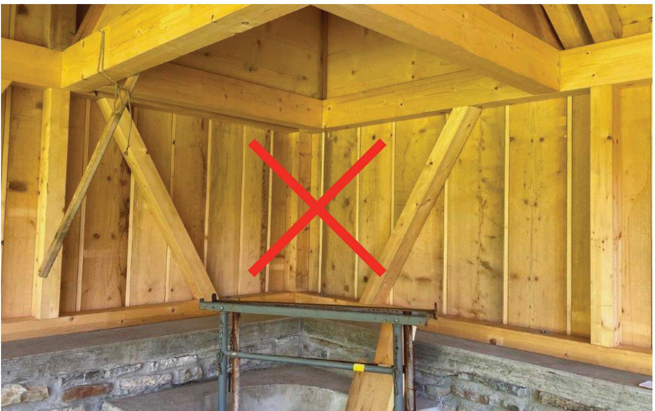
Die Steinmauer hinter der Feuerstelle muss ohne Unterbruch bis unter den Holzkamin reichen.
